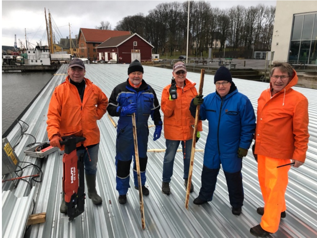
Flere arbeidslag bidro med dugnad i desember 2020 for å få på plass dekket på reperbanebrygga. Denne gjengen fikk æren av å legge på den siste stålplata. Foto: Torgny Alstad.
