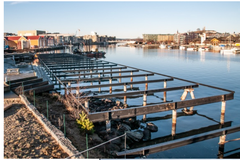
Det ble utført arbeid med reperbanebrygga utover høsten 2020. 66 pæler er slått ned i tønbergmorenen og deretter sikret mot korrosjon ved hjelp av utenpåliggende stålrør fyllt med betong. Foto: Runar Tveiten.
